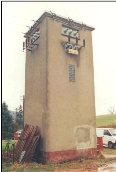
Trafostation Uder „Druschplatz“ (1999) „Bachrasen“
