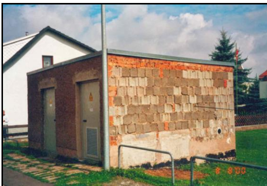
Trafostation Uder „Sportplatz“ (2000) „Sportplatz“ (2009)
